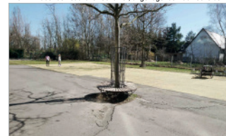
Blick 14...über den südlicher Schulhof, ungenügende Baumschleiben
